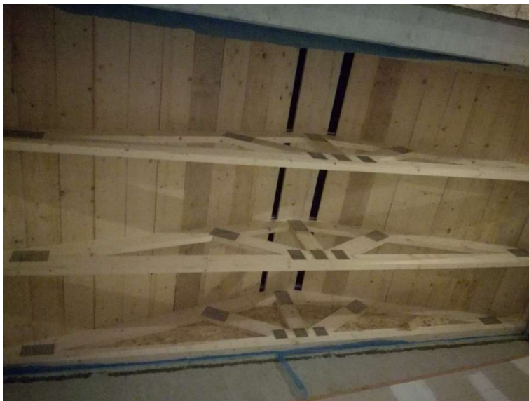
Abb. 9: Im Dachrahmen eingebautes Nagelplattenbinder-Dachsystem mit Eindeckung (senderraumseitig) ohne Unterdecke (empfangsraumseitig)
