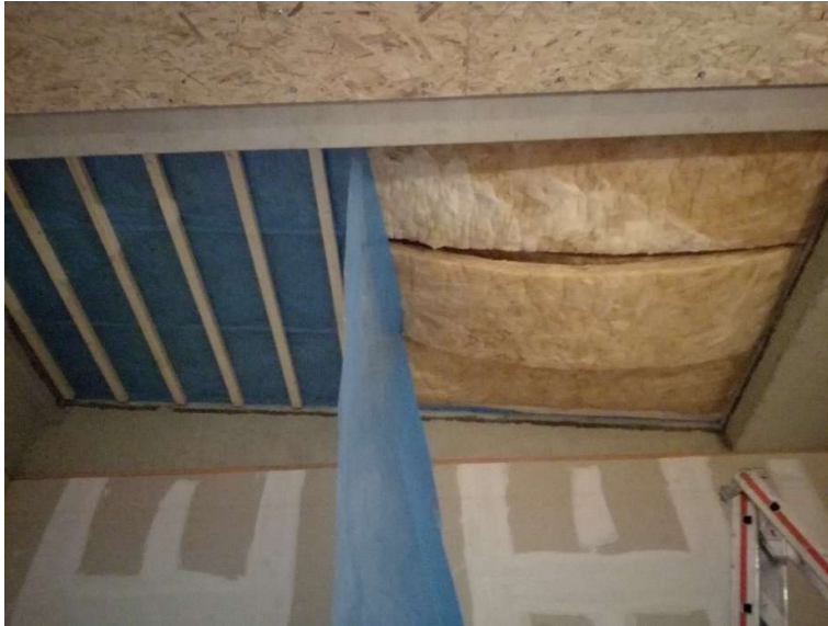
Abb. 8: Im Dachrahmen eingebautes Nagelplattenbinder-Dachsystem mit Eindeckung (senderraumseitig) beim Rückbau der Unterdecke (empfangsraumseitig)
