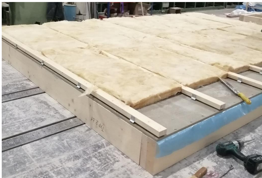
Abb. 6: Montage der Installationsebene durch Schwingbügel (empfangsraumseitig) am Beispiel von AW04 (Bild von Auftraggeber)
