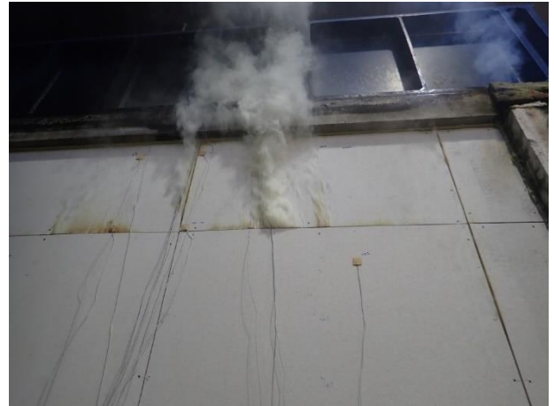
Bild 6.10: Prüfminute 58 – Starker Rauchaustritt aus horizontaler Fuge.
